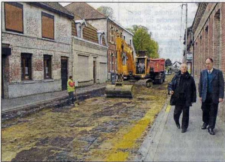
On en est actuellement au décaissement complet de la chaussée, rue Desmazières.
